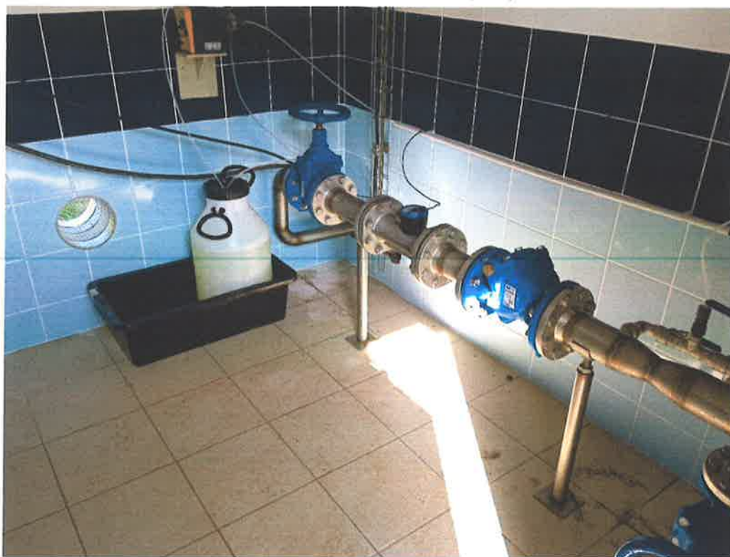
Nová armaturní komora zdroj Hajnice.
